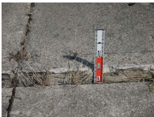
図8 津名港塩田地区岸壁の段差
