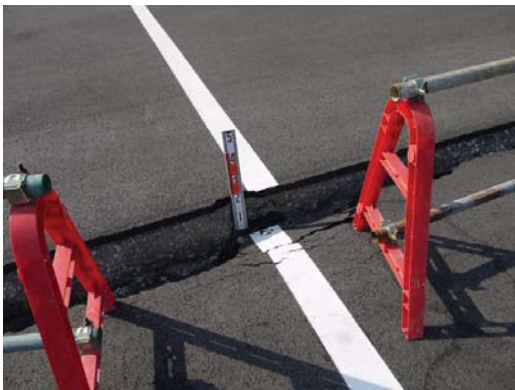
図 12 アスファルトの亀裂・段差
