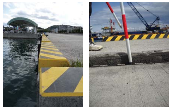
図9 津名港志筑地区の岸壁被害
