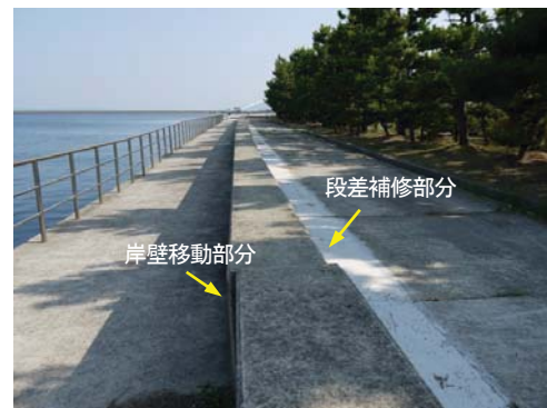
図10 津名港ターミナルビル北側の岸壁被害
