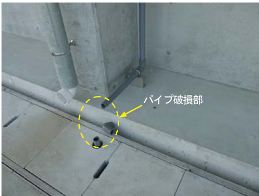
図 13 荷捌き所のパイプ接続部の破損
