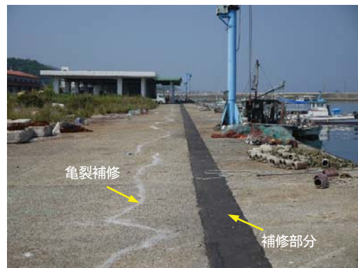
図 15 浅野漁港の岸壁被害
