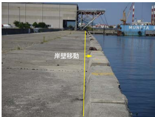
図7 津名港塩田地区の港湾施設被害
