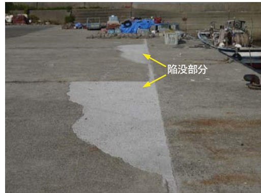
図 14 釜口漁港の水叩き陥没跡（補修後）
