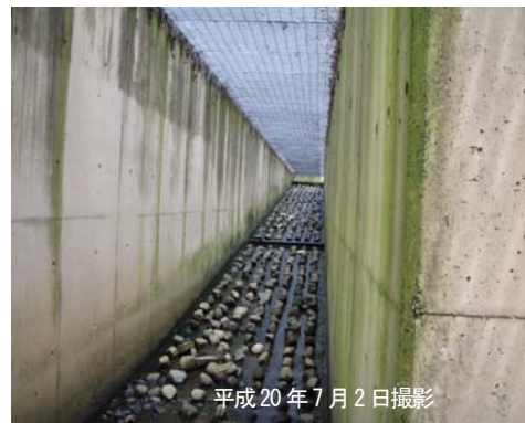
写真4 魚道(礎石付き斜路タイプ)
